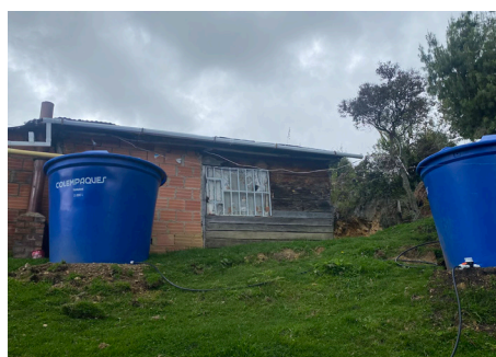
Installierte Regenwasser-Sammelbehälter beim Tota-See stellen Kleinbauernfamilien auch über Trockenperioden hinweg Wasser für den Haushalt und die Bewässerung ihrer Gärten zur Verfügung.
